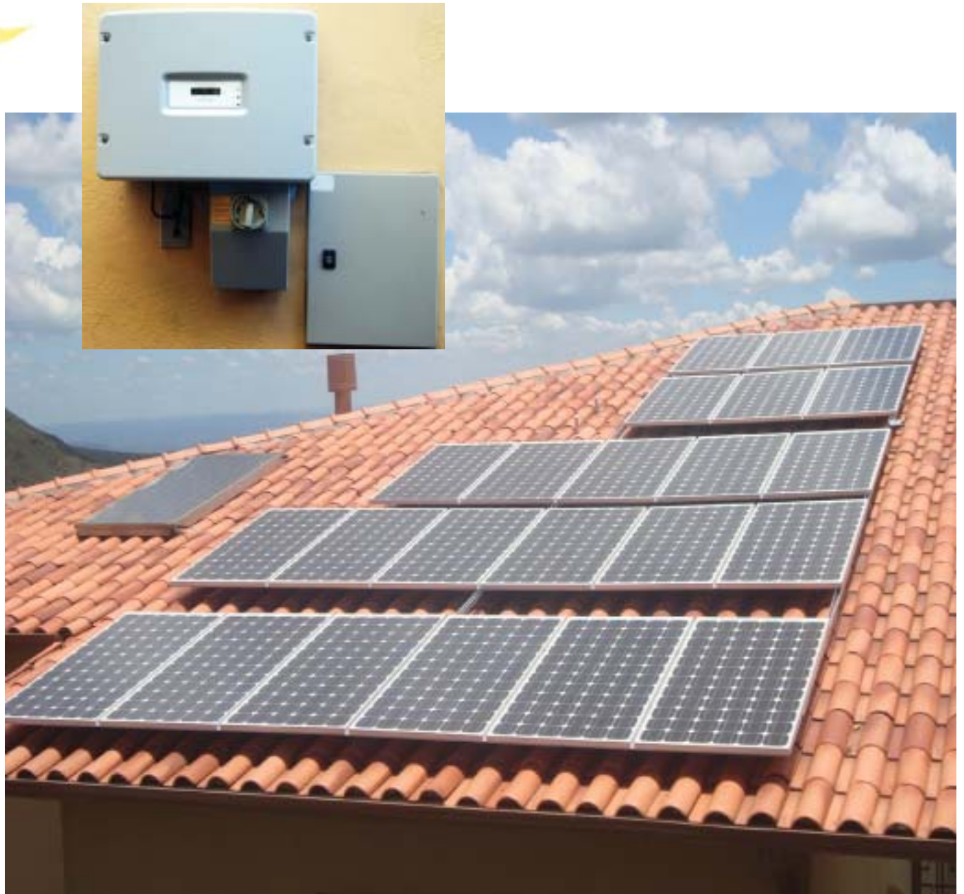
As placas transformam a luz solar em energia elétrica e o inversor de frequência (detalhe) converte a energia produzida em corrente contínua para corrente alternada
