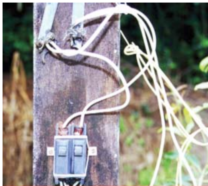
Figura 1 - Diga não as gambiarras! Uma boa proteção elétrica é fundamental para os equipamentos e operadores das máquinas
