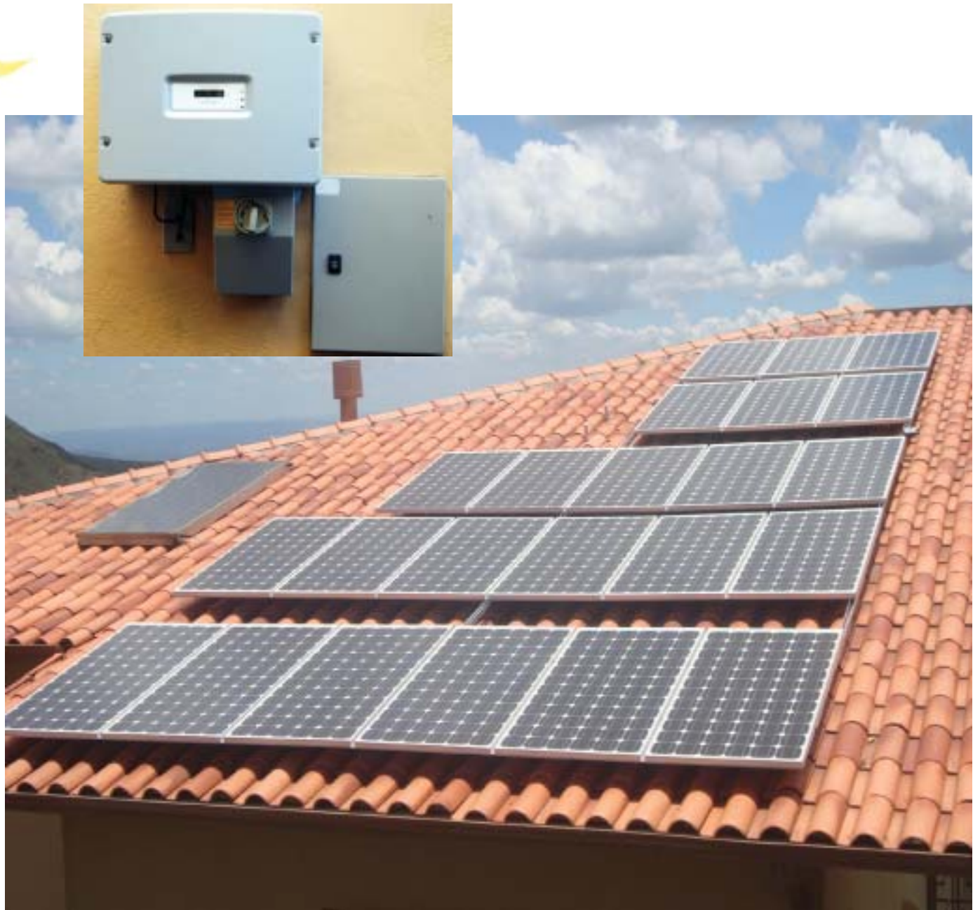
As placas transformam a luz solar em energia elétrica e o inversor de frequência (detalhe) converte a energia produzida em corrente contínua para corrente alternada
